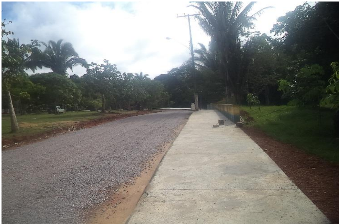
Construção realizada em 2018 – Calçadão de ligação de 600 m da entrada ao viveiro.
