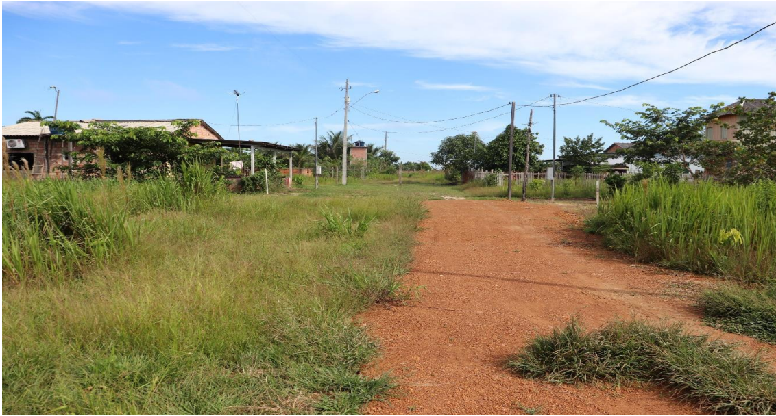
Foto 4. Detalhes do sistema de transmissão de energia elétrica.
